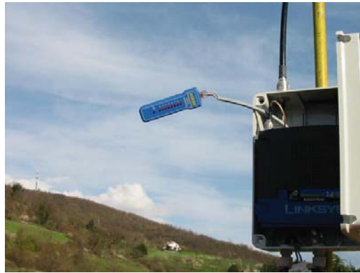
foto in cui si può notare la sonda ethernet per il controllo del cavo UTP5
